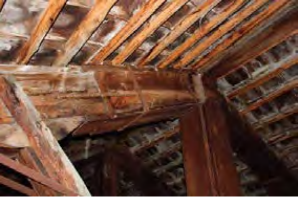
48. Sottotetto della Chiesa di s. Maria di Donnaregina. I gravi fenomeni di deterioramento del puntone est della capriata n. 4. Vista del modello generato dalla nuvola dei punti acquisita
