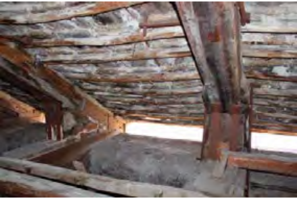
46. Sottotetto della Chiesa di s. Maria di Donnaregina. I gravi fenomeni di deterioramento del puntone ovest della capriata n. 5
