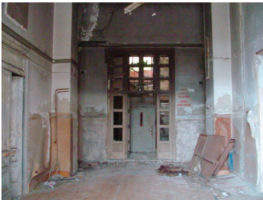
Figura 46. Lo stato di abbandono di alcune strutture del Preventorio di Pozzuoli
