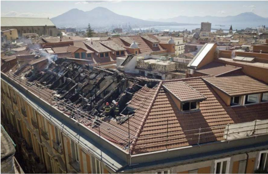
Figura 9. Giugno 2018 – Incendio della copertura del fabbricato (foto da Repubblica)
