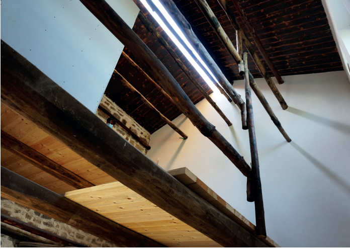
A sinistra: "casa del fuoco". Pagina a fianco: dettaglio della scala della "casa del fuoco". Foto di Francesca Iarrusso
