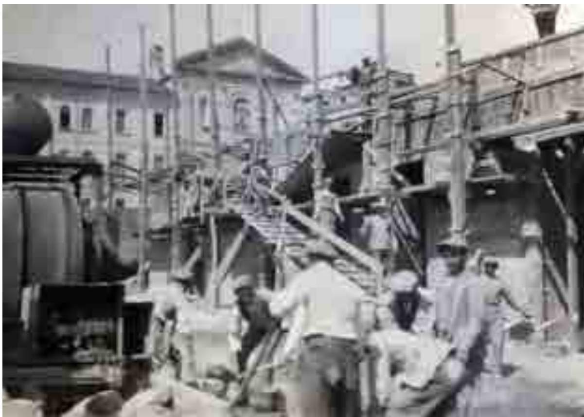
Salerno, cantiere per la costruzione del Liceo Tasso su progetto di Michele e Luigi De Angelis. Foto di Michele De Angelis
