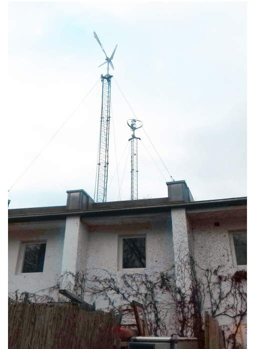
Fig. 3- Ufa Fabrik, mini wind turbine (Photo F. Dell'Acqua, 2018)
