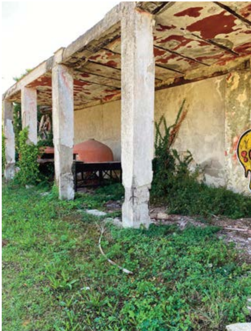
4. Napoli Mostra d'Oltremare. Padiglione Libia. La fatiscenza delle strutture in cemento armato e ferro del Padiglione Libia.
