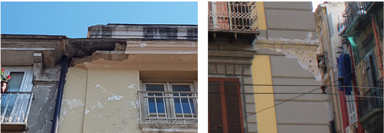
Fig. 2. Le posizioni d'angolo o di confine dei cornicioni incrementano i fenomeni di degrado. © 2019, Giovanni Ruggiero.
