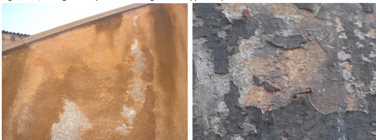
Figure 1-2 – esempi di degrado delle superfici intonacate
