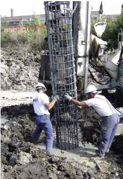
Fig. 129 Pali a elica continua con SCC nel cantiere dell'Alta Velocità tratta di Roma / Continuous Flight Auger piles with SCC in the building site of Alta Velocità in Rome
