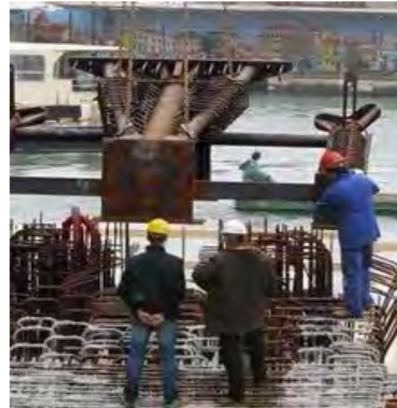
Fig. 76 Armature prima del getto di SCC nel ponte di S. Calatrava a Venezia / Armors before the SCC jet in the Bridge by S. Calatrava in Venice
