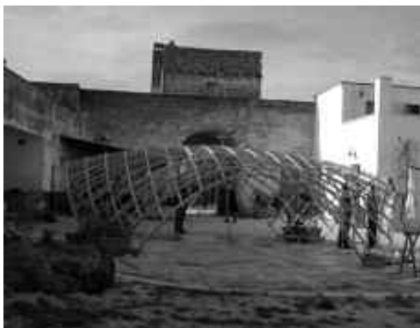
5. La griglia strutturale in fase di deformazione
