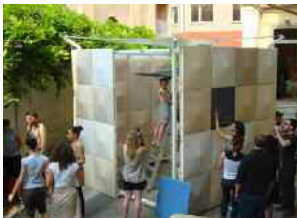
6. Laboratorio di Costruzione dell'Architettura I, Politecnico di Milano. Alessandra Zanelli, Carol Monticelli. Realizzazione di un progetto realizzato dagli studenti.
