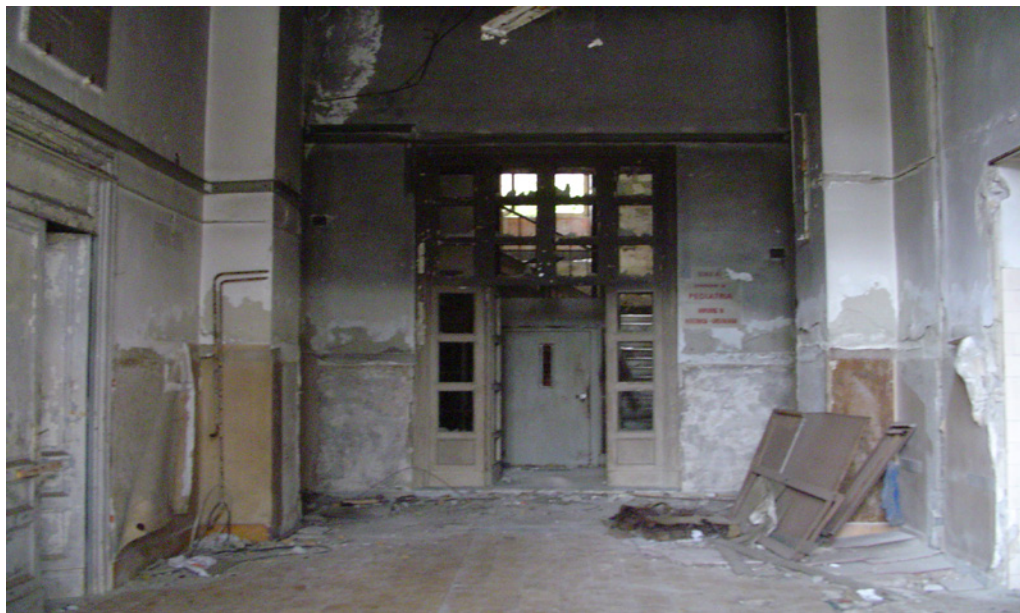
Fig. 2 - Lo stato di abbandono di alcune strutture del Preventorio di Pozzuoli. Fonte: M. D'Anna
