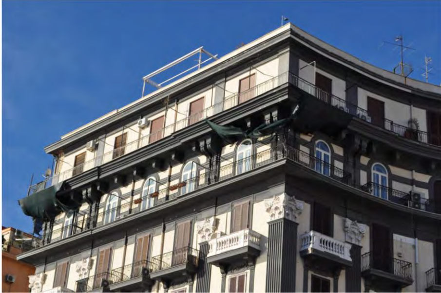
2. Esempio del rapido deterioramento delle reti protettive
