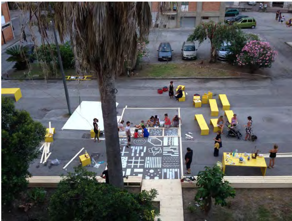
3. La piazza in fase di costruzione: momenti di convivialità, gioco e lavoro
