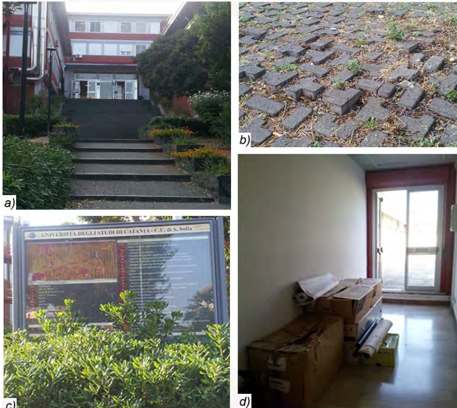
1. Alcuni degli elementi di criticità riscontrati nell'Ateneo Catanese: a), b) barriere fisiche evidenti, quali ingressi inaccessibili e pavimentazioni sconnesse; c) barriere percettive; d) uso improprio degli spazi.
