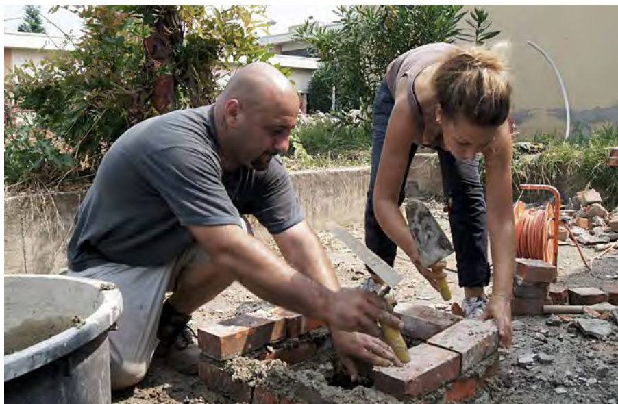
4. La costruzione di un pozzetto di ispezione. Nuovo spazio colloqui, Casa Circondariale Lorusso e Cutugno, Torino. Luglio 2015.
