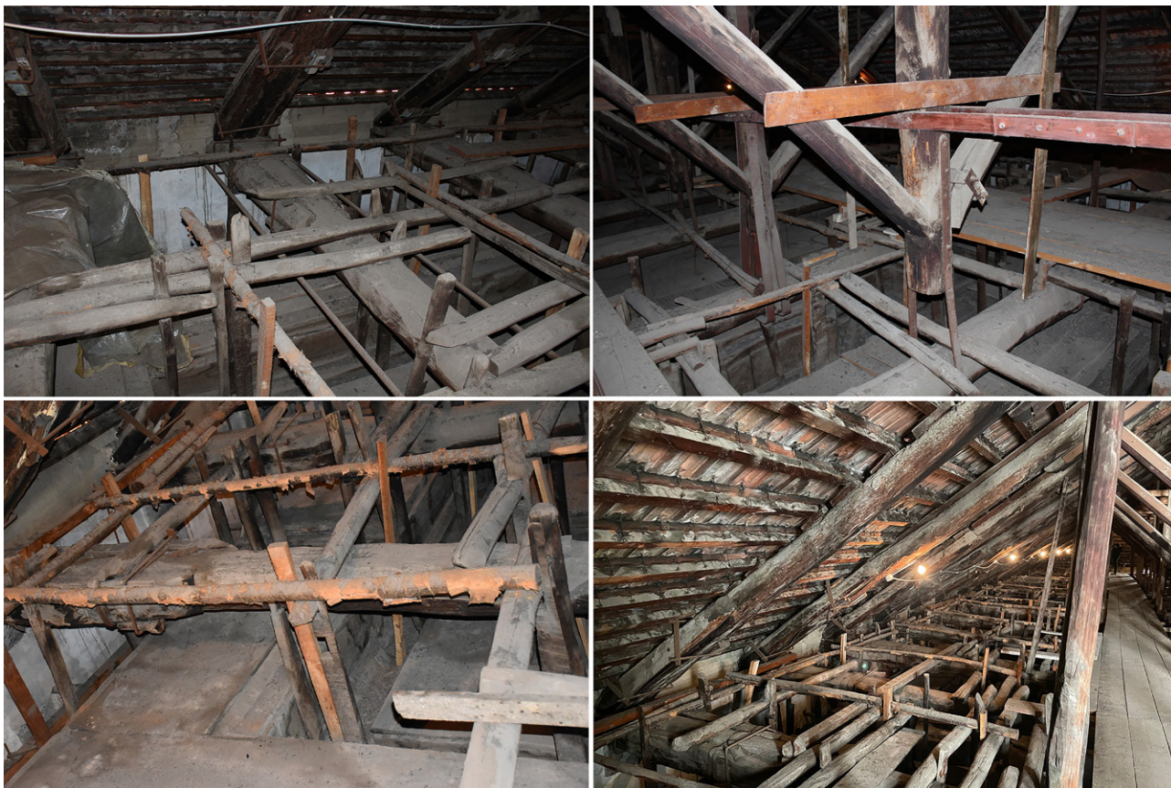
Fig. 1. Napoli, chiesa di Santa Maria di Regina Coeli, alcune immagini del locale sottotetto. Nella foto in alto a destra la fasciatura metallica che imbriglia longitudinalmente i monaci delle capriate; in quelle sotto, l'intricato sistema ligneo che regge il cassettonato (foto R. Amore 2023).
