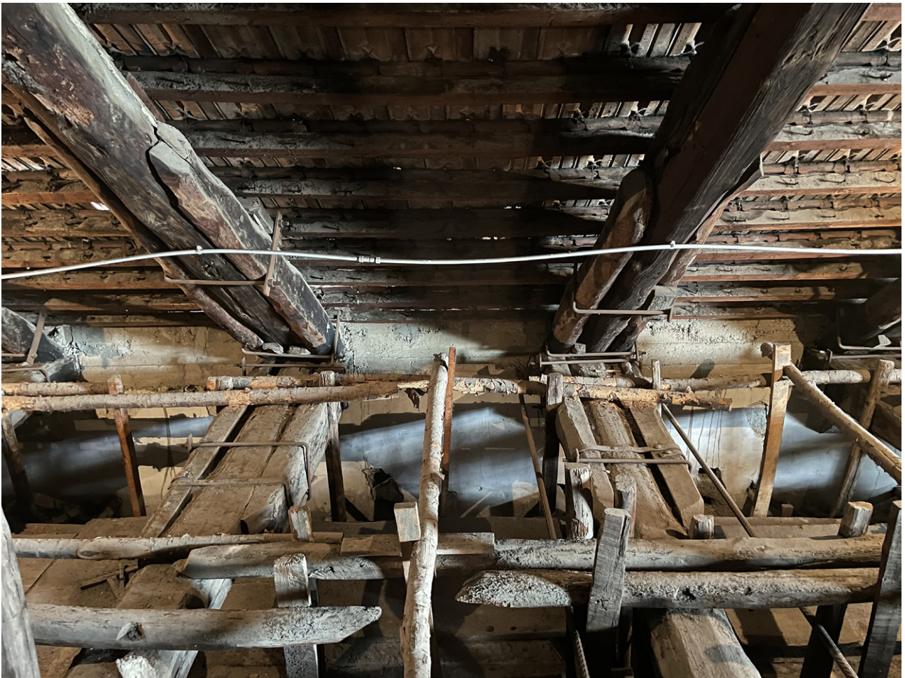
Fig. 2. Napoli, chiesa di Santa Maria di Regina Coeli, l'attacco di due delle diciassette capriate del sottotetto. In questa foto si possono notare molti degli interventi eseguiti nel corso dei lavori realizzati nel 1963. Il cordolo in c.a. che avvolge le teste dei puntoni e delle catene delle capriate; una delle quattro coppie di catene metalliche poste ai lati di quattro delle diciassette capriate; le staffature metalliche che legano insieme i 'mascellari di rinforzo' alle catene ed ai puntoni delle capriate. Alcuni dei correnti lignei a sezione quadrata che sorreggono il cassettonato, messi in opera ad integrazione o sostituzione di quelli esistenti costituiti da tronchetti semplicemente scortecciati (foto R. Amore 2023).
