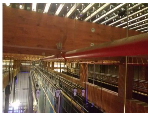
Figura 11 - Impianto a diluvio del Palcoscenico
