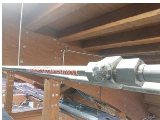
Figura 12 - Impianto water mist livello sottograticcia
