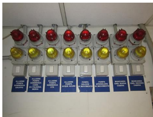
Figura 17 - Quadro allarme pompe e rete elettrica
