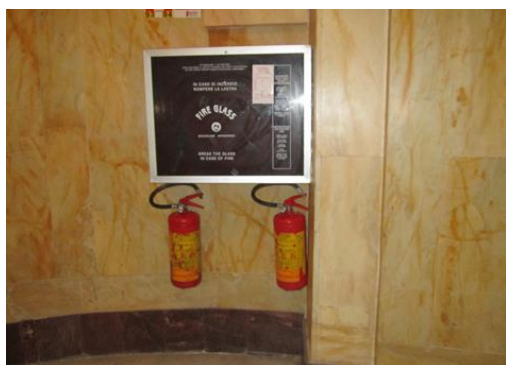
Figura 10 - Estintori e Idranti
