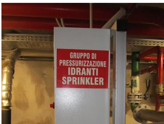
Figura 14 - Gruppi di pressurizzazione
