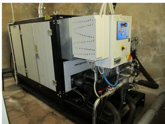
Figura 16 - Motopompa con gruppo di pressurizzazione
