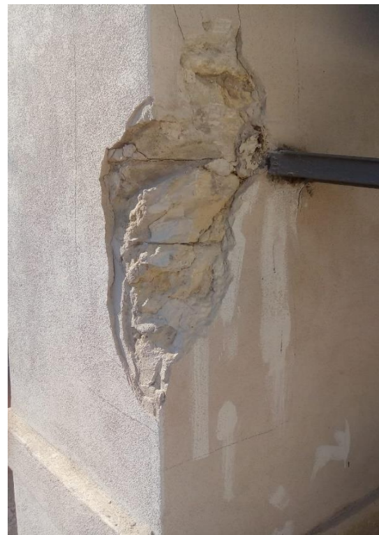
Figura 6. Stato della muratura ante intervento
