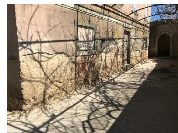
Figure 6. Humidade ascensional (créditos: Aníbal Costa)
