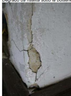
Distacchi di intonaco
