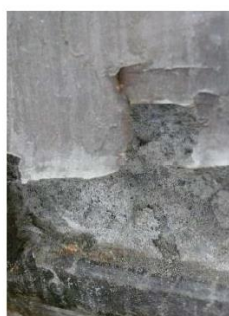
Degrado da risalita sotto la boiserie
