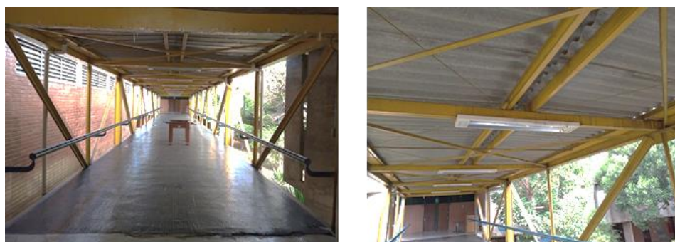
Figura 7. Vista do piso de revestimento das lajes e do corrimão e detalhe das telhas de cobertura e terças. Fonte: De autoria própria.
