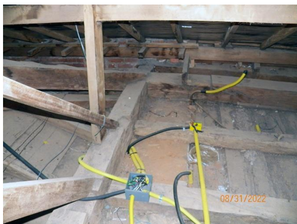
Figura 8. Detalhe dos problemas de manutenção preventiva no desvão do telhado. Fonte: Acervo dos autores, 2022.
