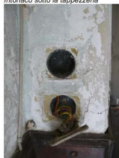
Manomissioni per gli impianti
