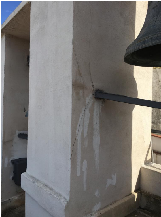
Figura 5. Lesioni del campanile a vela
