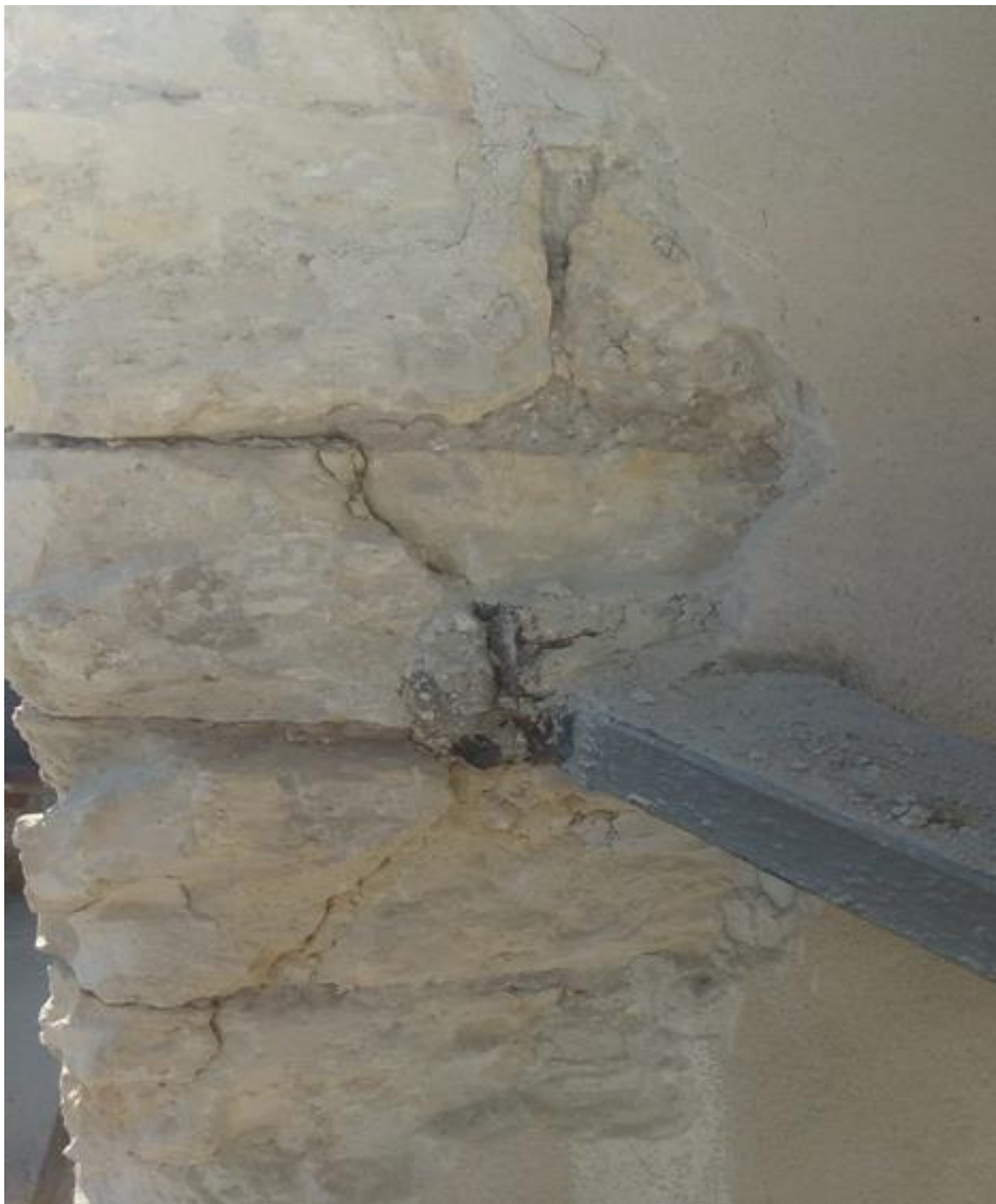
Figura 7. Dettaglio della muratura del campanile a vela ante intervento
