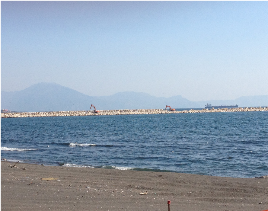
Fig. 12. Marina di Vigliena, Porto Fiorito. Realizzazione di un porto turistico e relative infrastrutture a terra (2012).
