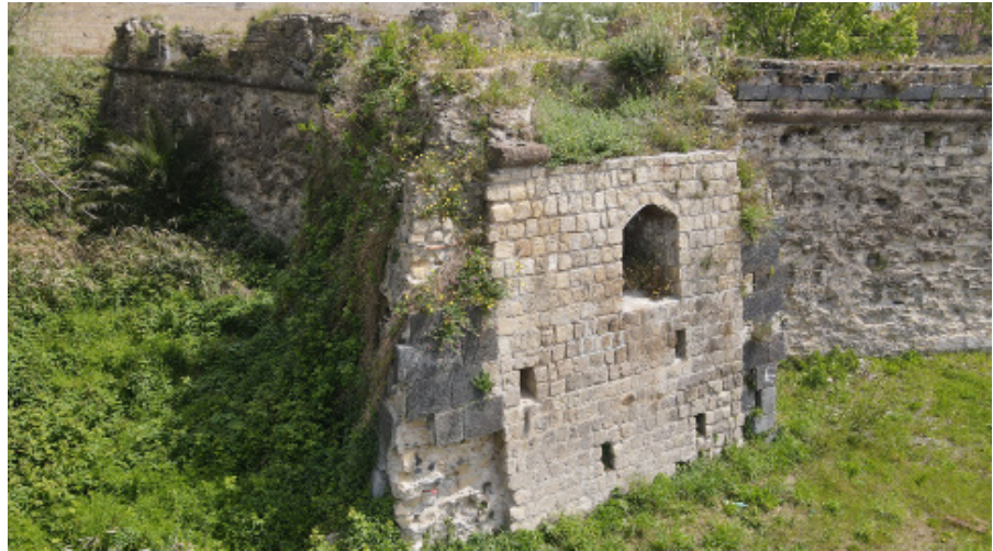
Fig. 9. Forte di Vigliena. Particolare dello stato di abbandono odierno (2022). Foto di C. Castagnaro.
