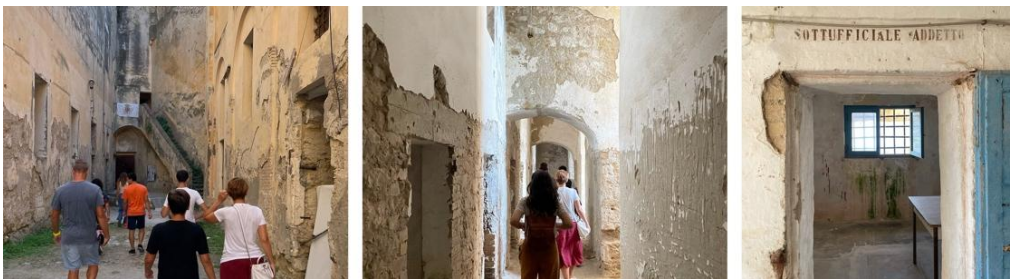
Fig. 6- Visite guidate presso il Castello angioino-aragonese di Gaeta: nonostante la messa in sicurezza di alcuni spazi e l'allestimento di alcuni ambienti resta necessario un intervento di restauro e musealizzazione (Foto dell'autore, 2023)
